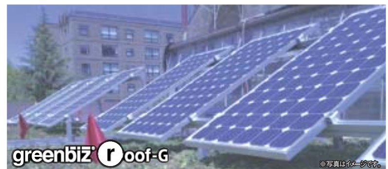
屋上緑化とソーラーパネルの組合わせで効率よく創電+節電
