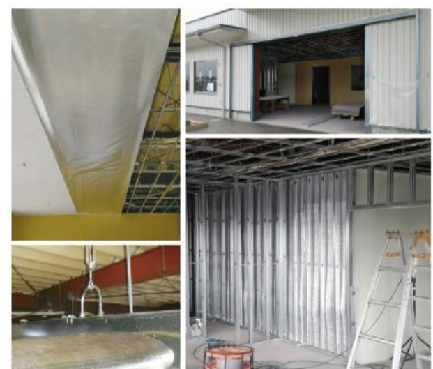
③ 東北地方・食品加工工場 ▶ 屋根遮熱・冷凍庫断熱結露対策工事
