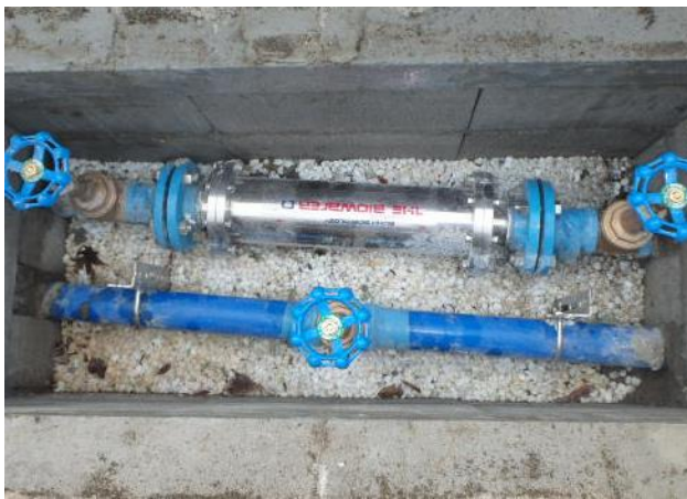
埋設配管への設置例
