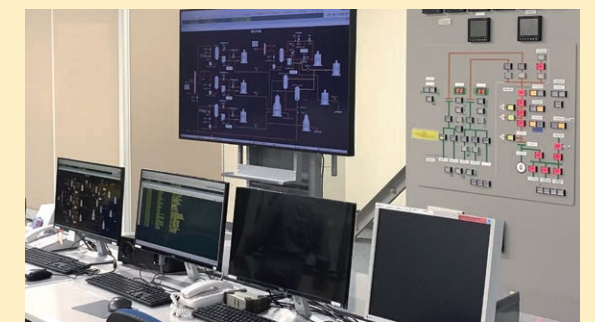
発電所の中央制御室の様子▶
