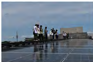
太陽光発電設備の説明
