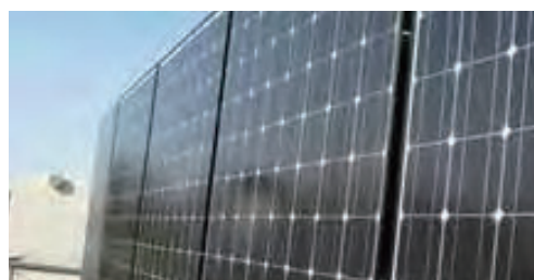
学舎屋上の太陽電池モジュールパネル
