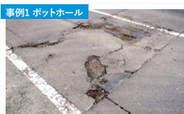
事例1 ポットホール
