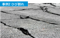
事例2 ひび割れ
